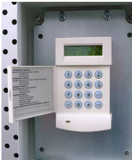
Kodepanel for AIA. FOTO Forsvarsbygg
