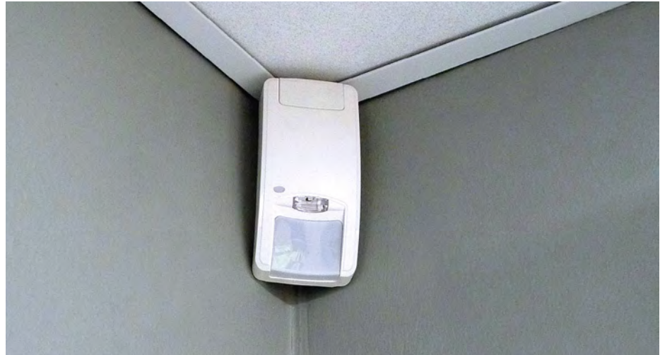
Passiv infrarød detektor. FOTO Forsvarsbygg
