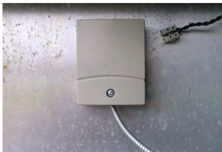
Seismisk detektor på stålvegg. FOTO Forsvarsbygg
