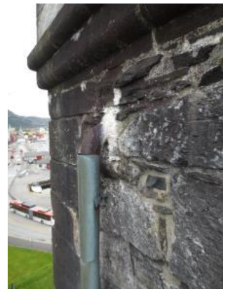
Nedløpsrør av kobber mot øst. Kalkutfelling ved jernrør tyder på vann på avveie.
