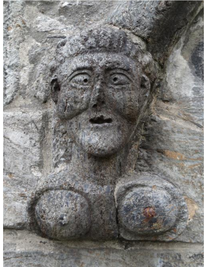
Flere riss i brystet t.h., stråler ut fra rust/ekspansjon i jernbolt.
