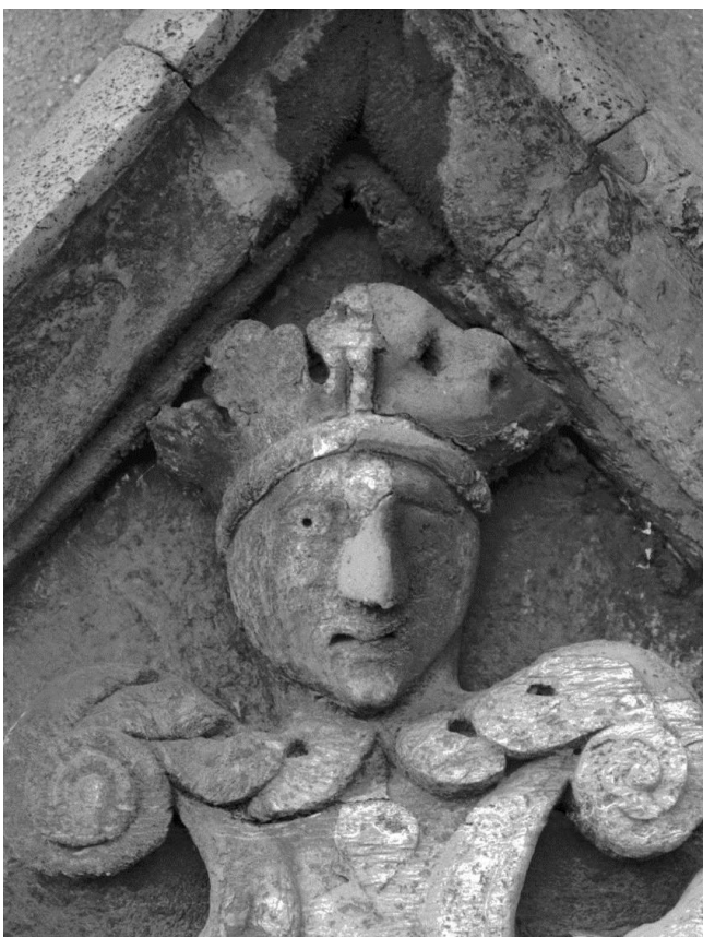
Fasade sør, våpenskjold 3. etasje. Sementreparasjoner på krone, nese mm, muligens fra 1800-tallets restaurering.
