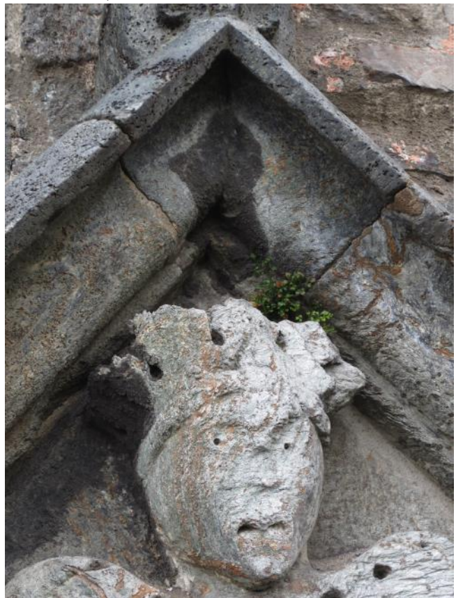
Sementreparasjoner er hugget vekk, trolig i 1950-årene. Planten murburkne (rødlistet) vokser frodig i fugen over krona. Sort skorpe i topp av båndet, noe endret omfang.
