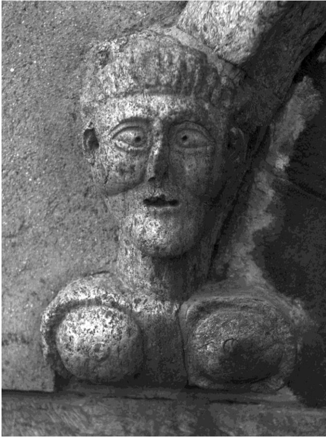
Fasade sør, 3. etasje. Ingen riss i brystet t.h., som er reparert tidligere, fugging omkring og midtstilt jernbolt.
