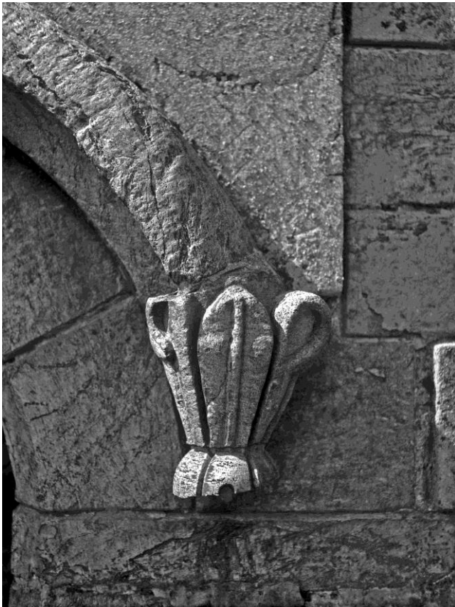
Fasade sør, 4. etasje. Nedre del av steinen under jernet er allerede falt av, og er trolig beholdt i denne tilstanden uten reparasjoner ved Fischers restaurering.
