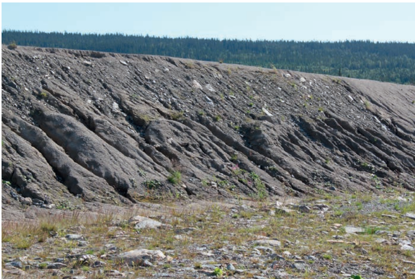
Fig. 64. Kraftig erosjon i fronten av skytevoll i RØ etter sterk nedbør. I tillegg til de fysiske skadene medfører erosjonen også lekkasje av tungmetaller med erosjonsvannet.
