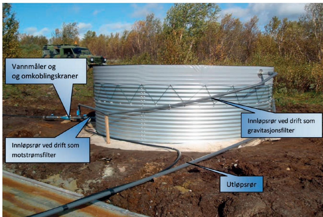
Fig. 25. Perkolasjonsbassenget ved utløpet av Jernbanestollen. Bassenget kan driftes både motstrøms og medstrøms.
