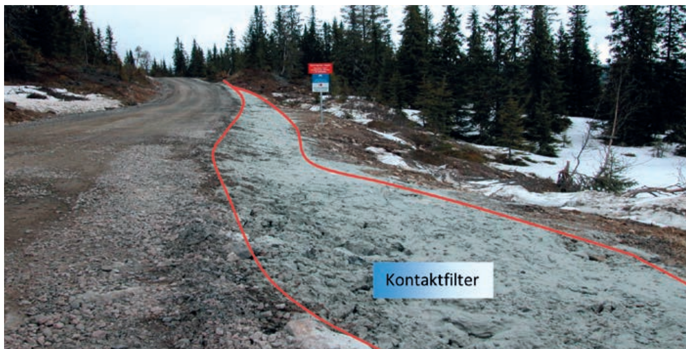
Fig. 2. Det første kontaktfilteret med olivin som ble bygget ved Deifjellet. Filteret er nærmere beskrevet under kapittel 2.
