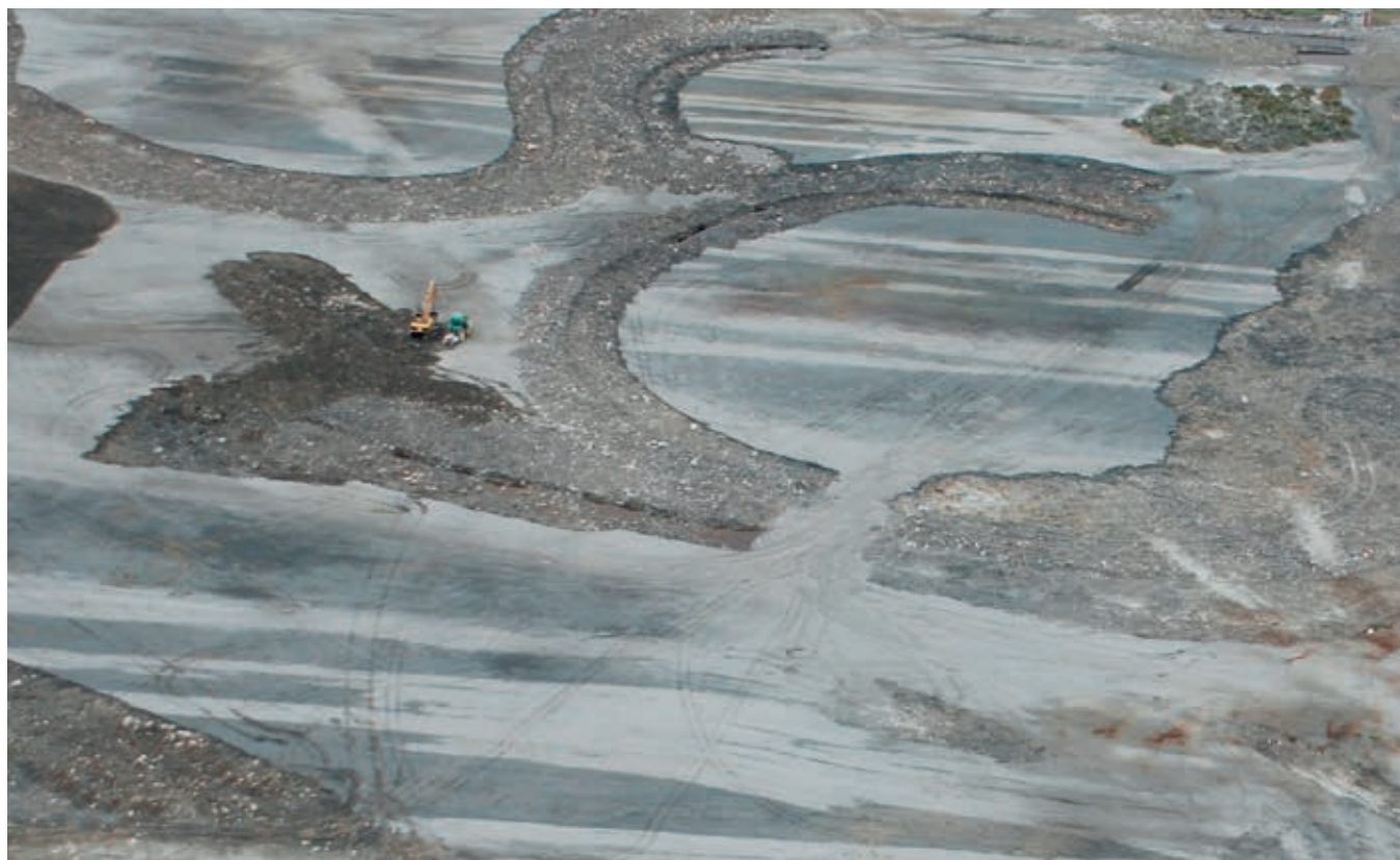
Fig. 43. HFK-sletta under rehabilitering. Inngrepene medførte en forverret situasjon for avrenning av tungmetaller til Grisungbekken.
