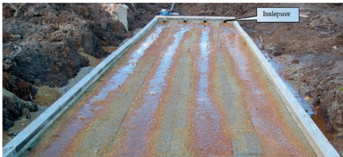
Fig. 31. Kontaktfilteret etter 4 måneders drift. Den brune fargen skyldes jernutfelling.
