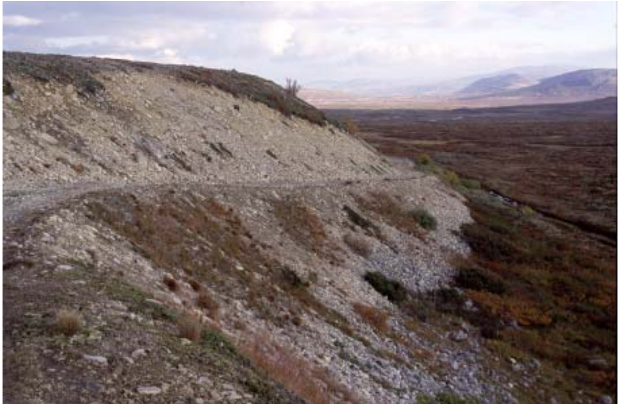
Utbedring av skader i bratt terreng, og med grove masser, kan fort føre til nye skader og erosjon. Bilder viser ei vegskjæring i den sentrale delen av skytefeltet.
