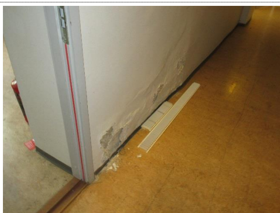
Bilde nr. 35 Det er registrert mye fuktoppsug i vegger i kjelleren.
