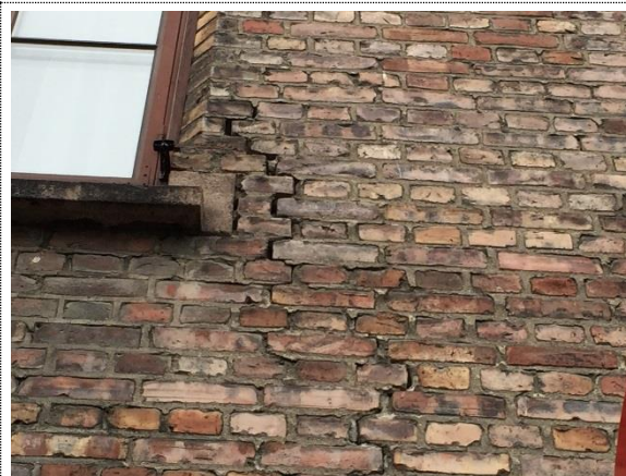
Bilde nr. 60 Setningssprekker i fasadene en rekke steder.
