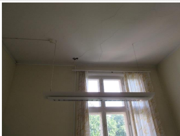
Bilde nr. 27 Det er registrert mye risser/sprekker i både vegger og himlinger.
