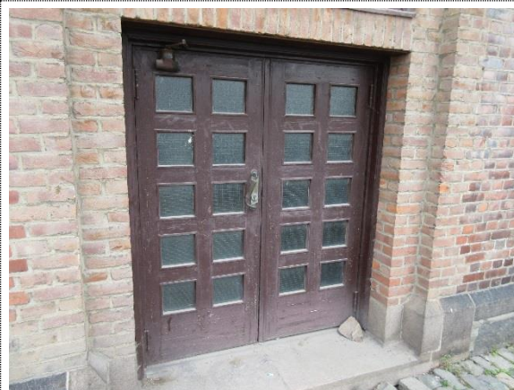
Bilde nr. 128 Slitte, uttørkede inngangsdører på vestfasaden.
