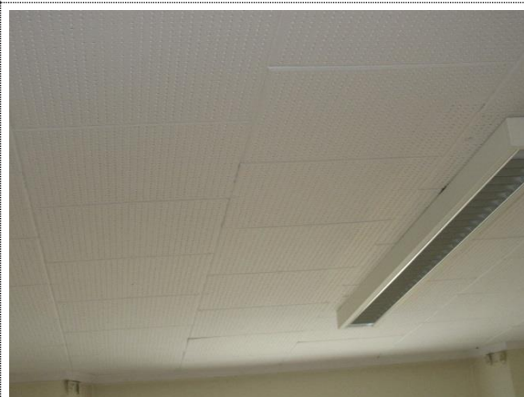
Bilde nr. 144 Lokaler med gammel, perforert platehimling.
