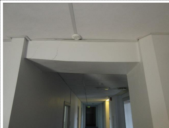
Bilde nr. 32 Skade i drager over utsparing – skyldes trolig setninger i bygget.
