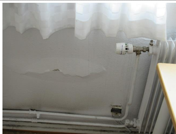
Bilde nr. 152 Skade i yttervegg pga. fuktoppsug.
