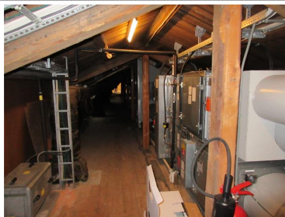
Bilde nr. 74 Kaldloft med ventilasjonsaggregat for sørtårnet.
