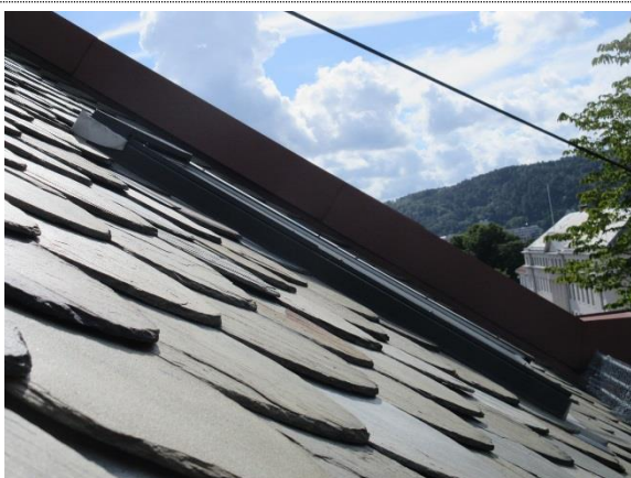
Bilde nr. 17 Yttertaket er tekket med skiferstein av ukjent alder. Det er registrert lekkasjer.
