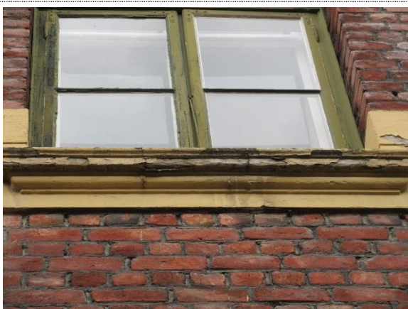
Bilde nr. 5 Mye skadet puss og sprekker på pussede flater. Her vises en sålebank.
