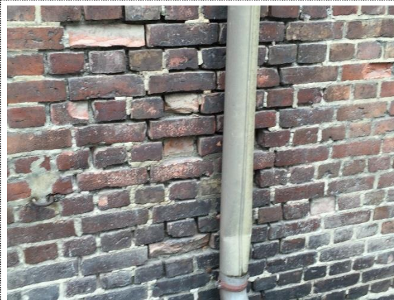
Bilde nr. 58 Mye dårlig spekking er registrert. Skaden på bildet skyldes trolig lekkasje fra nedløpet over tid.
