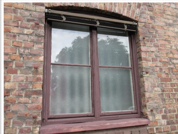
Bilde nr. 126 Gamle trevinduer i dårlig vedlikeholdt stand.
