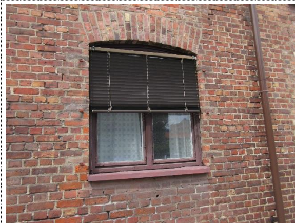
Bilde nr. 124 Gamle trevinduer i dårlig vedlikeholdt stand.
