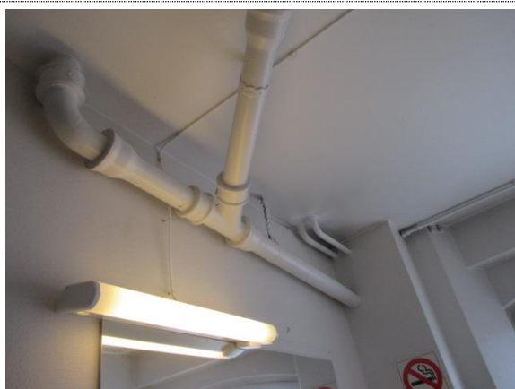
Bilde nr. 155 Eldre vann og avløpsrør i hele bygget – trolig fra 1950-tallet.
