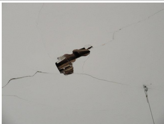
Bilde nr. 31 Skade i himling.
