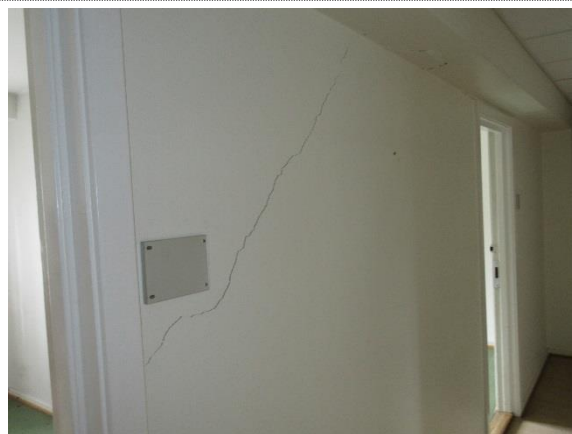
Bilde nr. 154 Setningssprekk.
