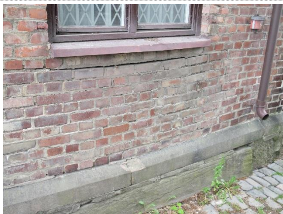
Bilde nr. 129 Spekk under vindu – mulig setningsskade.
