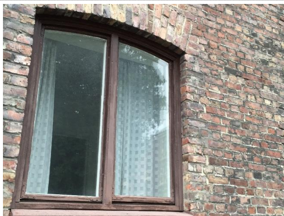
Bilde nr. 57 Gamle, slitte trevinduer.
