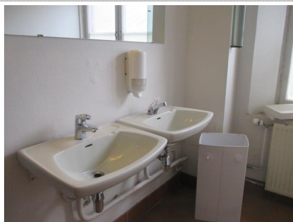
Bilde nr. 156 Nyere sanitærutstyr.
