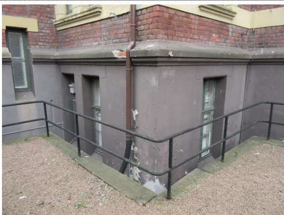
Bilde nr. 3 Mye avflassing pga. fuktoppsug på sokkel/grunnmur.
