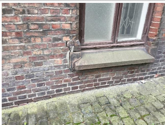
Bilde nr. 59 Utslitt vindu og setningssprekker rundt vindu.
