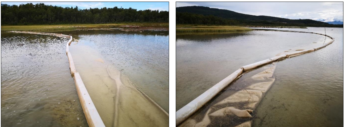
Figur 13. Bilder av slam-avsetninger i innløpsbekk til Kjerkvatn fra anleggsområdet, og siltduk lagt ut i Kjerkvatn for å hindre videre spredning til Kjerkvatn av finpartikulært materiale avsatt i omkringliggende terreng, august 2021. (Foto: G. A. Dahl-Hansen, Apn).
