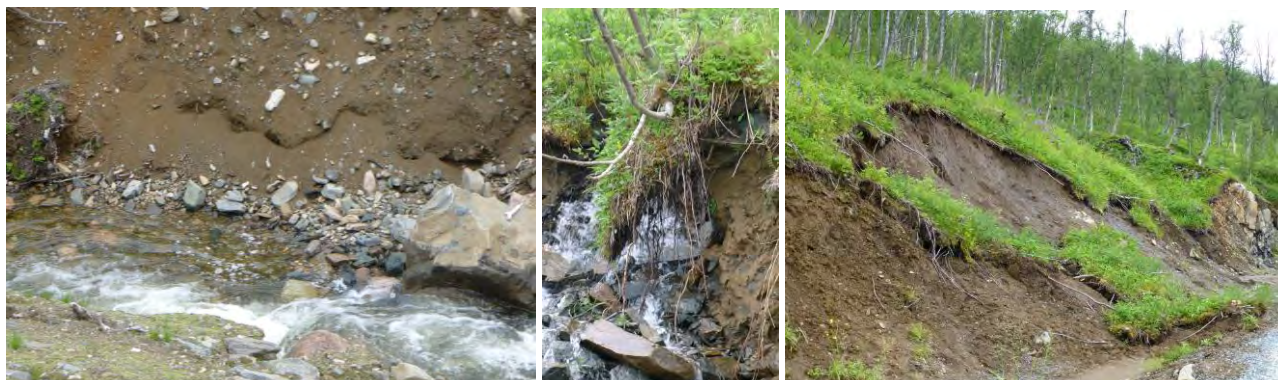
Figur 13: Eksponert jord og løsmasser langs sammenbindingstraseen (t.v) og synlige erosjonsskader langs veikanten (t.h). Disse skadene kom som følge av kraftig nedbør over en kort periode.
