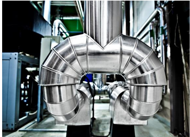
Bildet er tatt i energisentralen i Bardufoss leir
