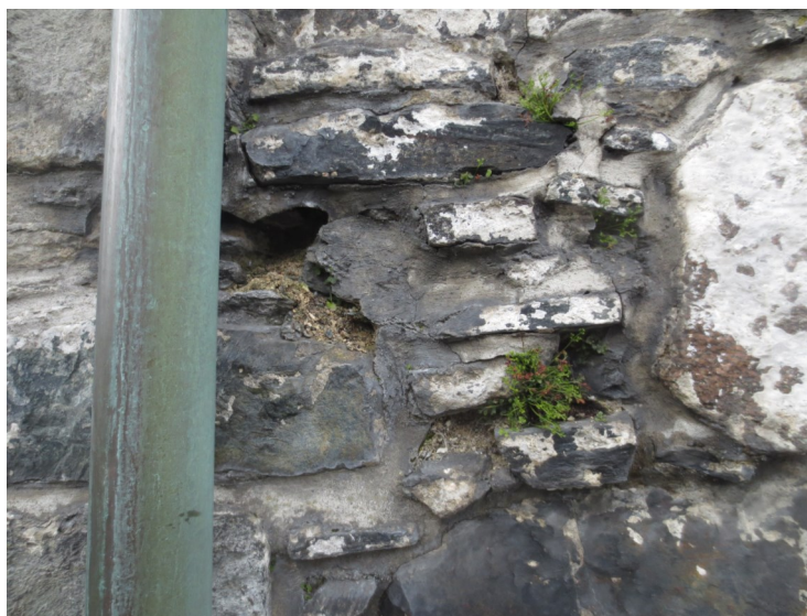
Sementspekkingen faller ut, fugene er sterkt nedfuktet og gir grobunn for rødlistearten murburkne. Enkelte pinningsstein fungerer som vannhyller i murverket.
