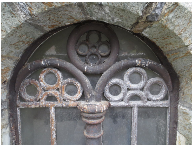
Det er bevart noen få jernvinduer fra restaureringen i 1848. Disse har flotte detaljer, men er sterkt angrepet av rust.
